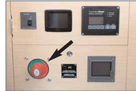
VALVOLA DI SICUREZZA GENERALE DI BORDO
