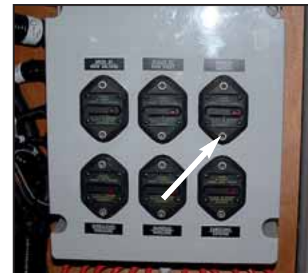
DISJONCTEUR DES CABESTANS
