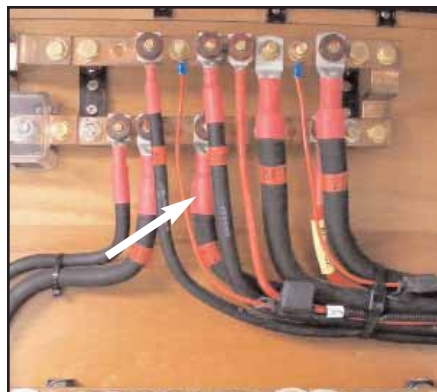
FUSIBLE DEL SISTEMA HIDRÁULICO (PASARELA)
