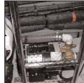
POMPE DE CLIMATISATION
