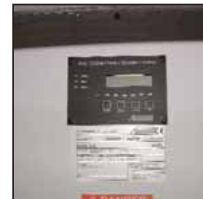
CENTRALE DE COMMANDE
